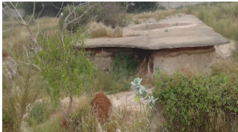
Photo 1 : Ravinement sur le site
